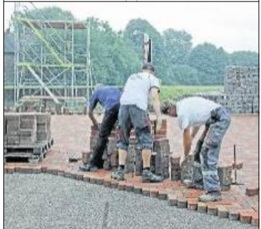
Der Parkplatz vor dem Riad nimmt Formen an. Die Pflasterarbeiten laufen auf Hochtouren. RN-Foto Witte
